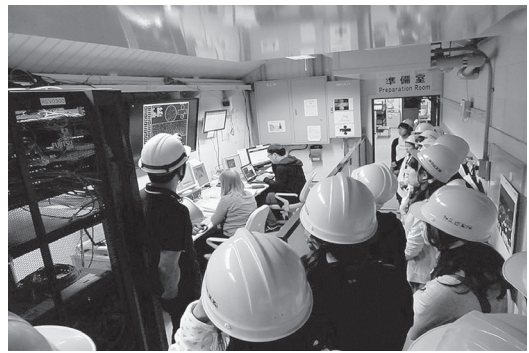
図6 コントロールルーム
